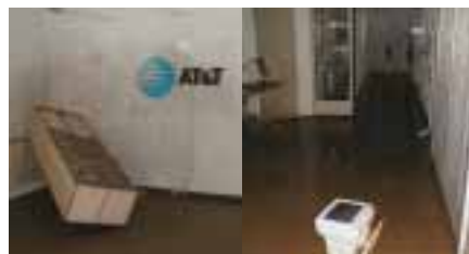
Die überschwemmten Büroräume von AT&T.
